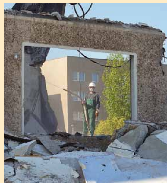
Durch den Abriss von Gebäuden in Bernburg Süd-West konnte die Leerstandsquote halbiert werden.
